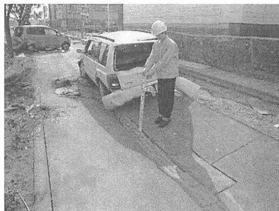
写真-4 マンホール周辺の陥没
