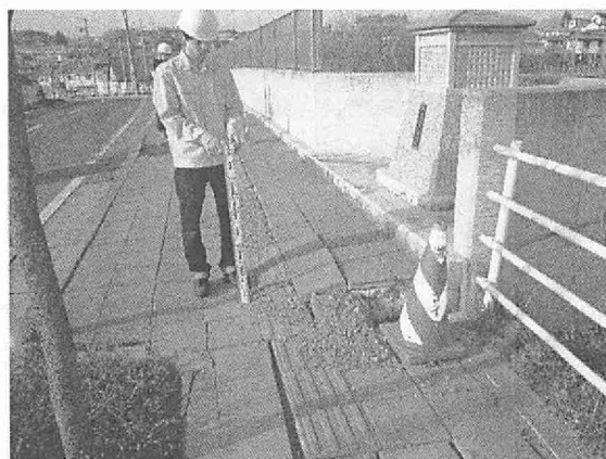
写真-15 盛土と橋梁の接合部の段差
