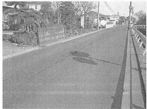
写真-24 多賀城市新田の道路亀裂部分
