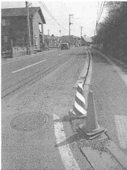
写真-20 道路陥没
