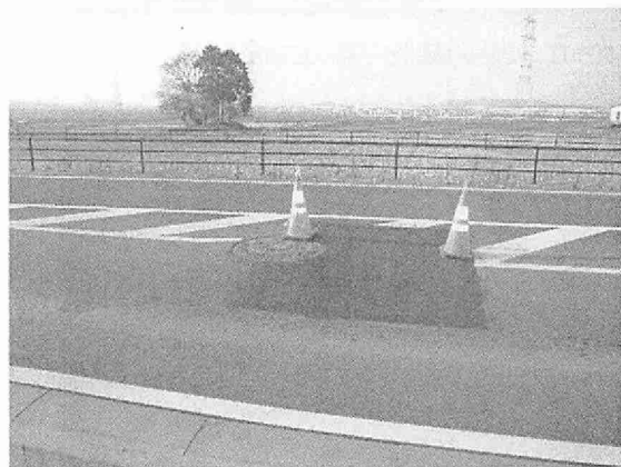
写真-13 マンホール周辺の陥没
