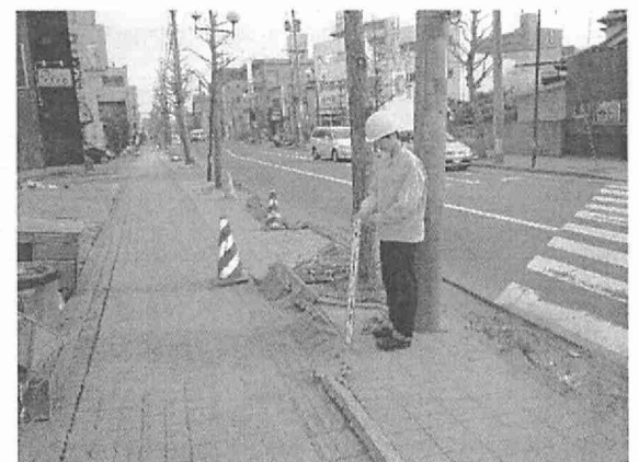
写真-2 多賀城市桜木の歩道めくれ
