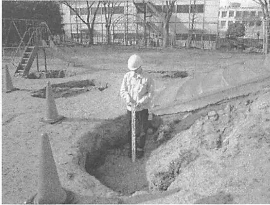
写真-25 多賀城市役所前公園の陥没
