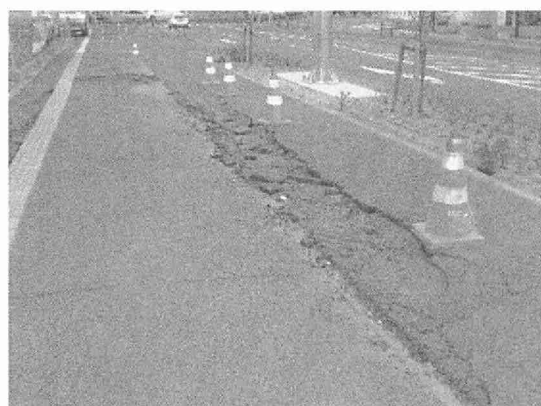
写真-9 歩道沈下写真
