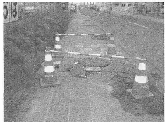
写真-8 マンホール浮き上がり
